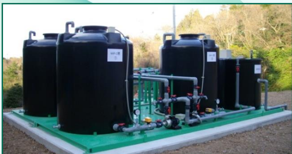
■ 実績例：処分場浸出水中のヒ素処理 (80m 3 /時 関東圏内)
