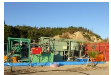
■ 実績例: 重金属類 複合汚染 10m 3 /時 広島県
